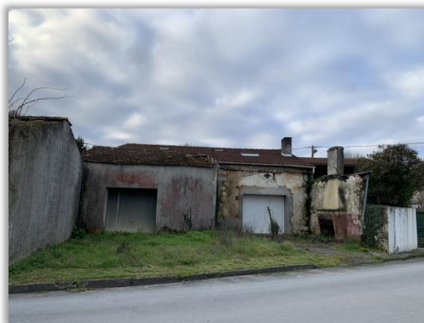
Des ensembles bâtis dégradés
